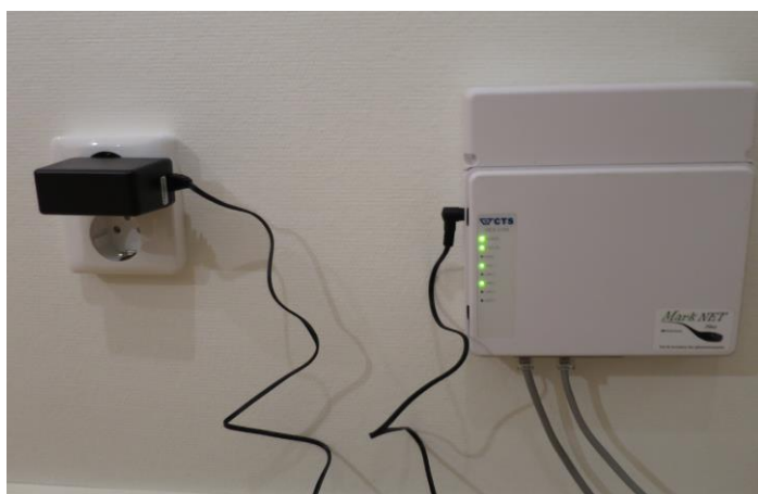
Bild: CPE uppsatt på vägg med transformator i eluttag och anslutna datakontakter.
